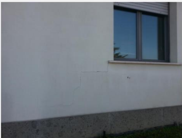
Stato fessurativo marzo 2015
